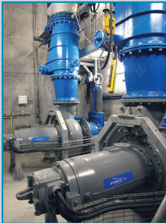
Pumper til regnvand (2 stks. CZ 3551, 125 kW)
