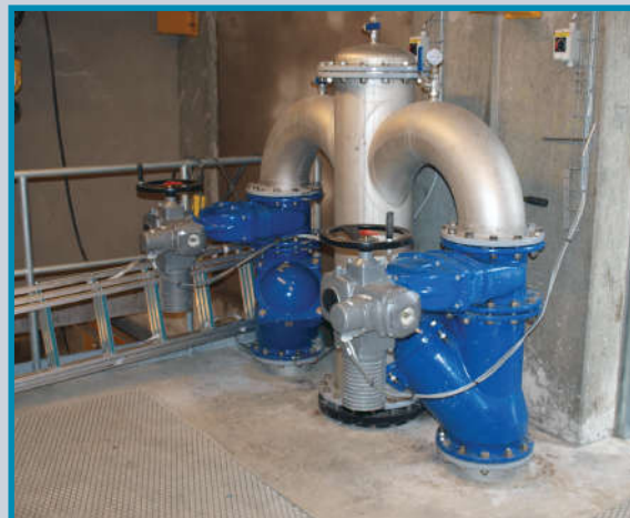
Ventiler og afsenderstation til rensegris, for spildevandspumperne.
